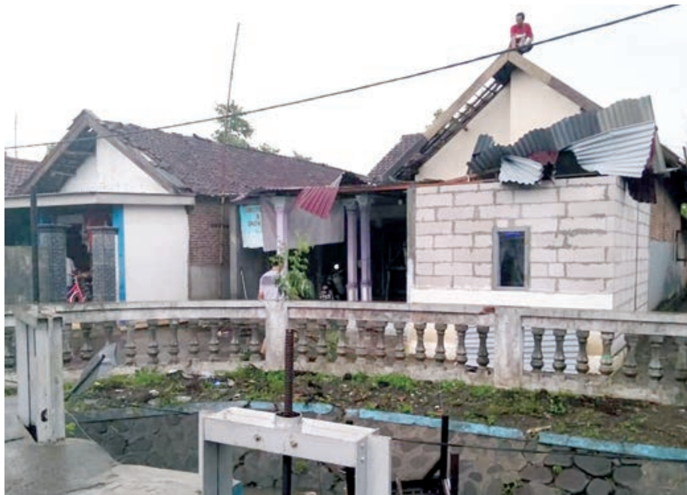
RUSAK: Rumah terdampak puting beliung di Desa Bakung Pringgodani, Balongbendo.
