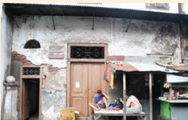
LANGGAR SAGIPODIN: Kondisi Langgar Gipo nampak dari depan yang dibangun oleh keluarga Sagipodin di kawasan Jalan Kalimas Udik, terlihat tak terawat, Sabtu (16/2).
