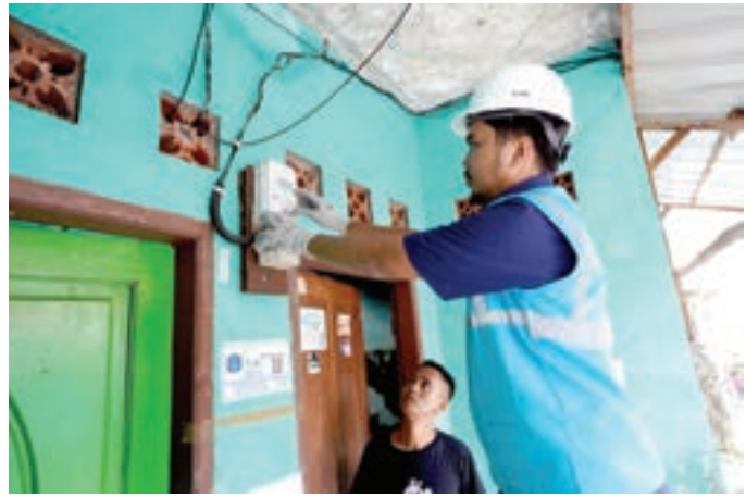
BISA PANTAU PENGGUNAAN LISTRIK: Petugas PLN melakukan penggantian kWh meter ke smart meter di salah satu bangunan pelanggan.
